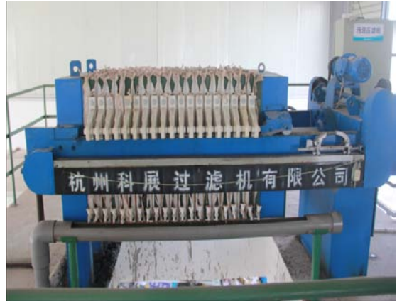
污水处理设备：全自动板框压滤机
