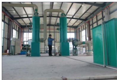
广博废水处理站内景
